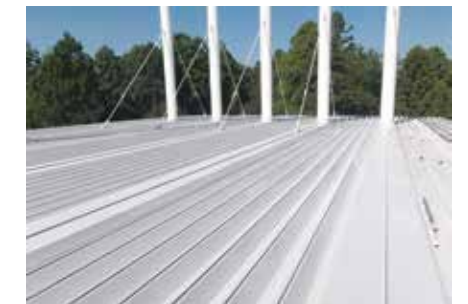
美術館(福井県)折板屋根(遮熱・消音)
