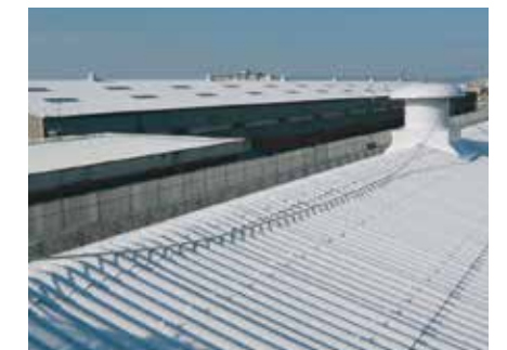
工場(兵庫県)スレート・波板屋根(遮熱・保護)
